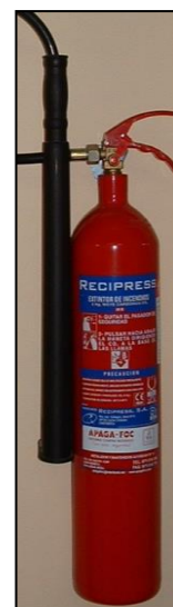
Extintor de CO 2
